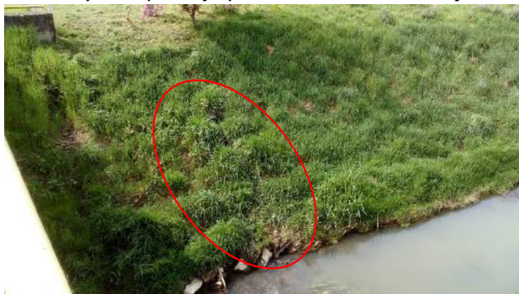
Slika 6.11-23. Ispust 7 u vodotok Bukvik - ilegalni
